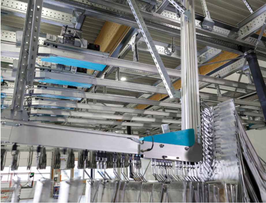
Schonende Handhabung und kompletter Anlagenüberblick – auch beim Bewegen zwischen den Ebenen
